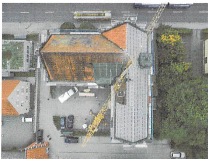
▲ Baustelle von oben: Das imposante, rund 1000 m 2 große Dach wurde in mehreren Abschnitten saniert und energetisch ertüchtigt
