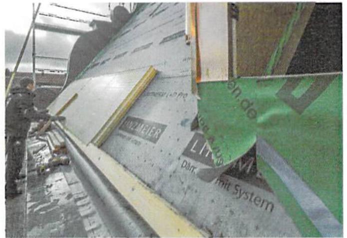
▲ Für die Dachdecker war es kein Problem, die Dämmung auf der 1000 m 2 großen Dachfläche in etwa vier Wochen zu verlegen
