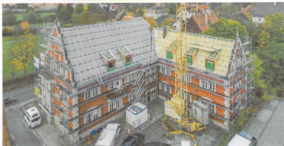
▲ Gelungene Sanierung: Sowohl der Blower-Door-Test als auch die energetischen Kennzahlen des gewählten Dachaufbaus attestieren dem alten Gebäude einen modernen Standard
