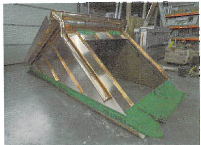
▲ Eine von insgesamt zwölf neuen Gauben steht hier fertig verblecht in der Werkstatt für den Abtransport zum alten Amtsgericht bereit
