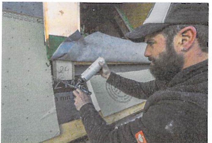
▲ Gaube im Detail: Hier galt es sauber zu arbeiten, um eine homogene Dämmebene über der alten Holzkonstruktion zu bilden
